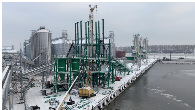
Крепление опорных колонн трубопроводов к монолитным фундаментам (минимальные расстояния от края железобетонного элемента)
