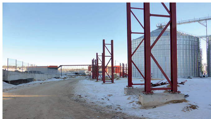
Крепление опор теплотрассы и газовой эстакады к фундаментным бетонным блокам (производство работ в условиях строительной площадки в зимний период)
