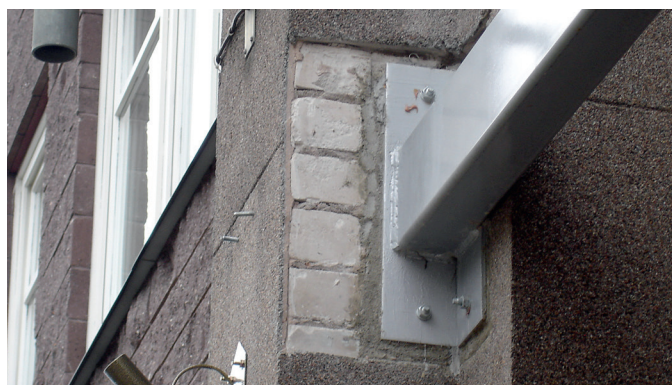
Монтаж несущих элементов рольставней к кладке из силикатного кирпича (повышение надежности крепления при заделке анкеров во второй ряд кирпично
