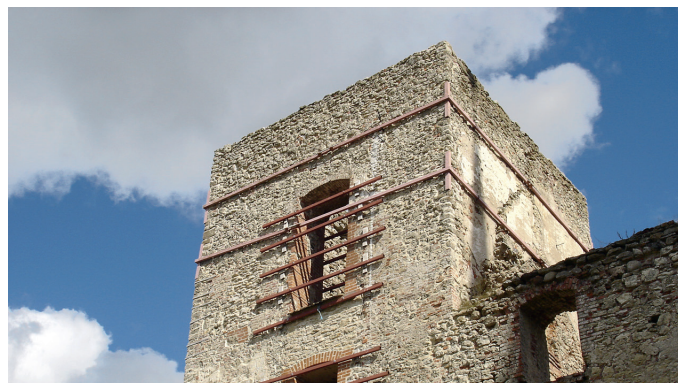
Крепление элементов металлической обвязки к кладке стен из природного камня при усилении памятника архитектуры 16 века
