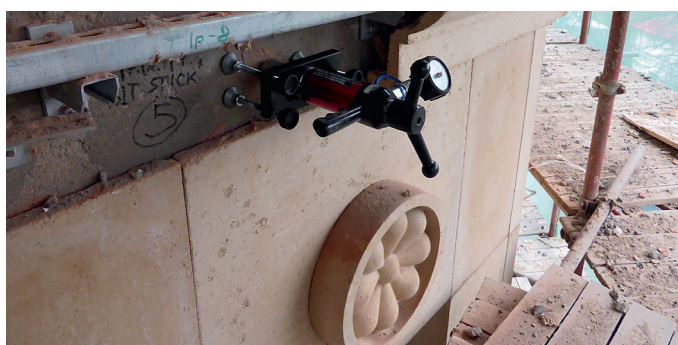
Приемо-сдаточные испытания анкеров для крепления подсистемы архитектурных изделий, выполненных из стеклофибробетона (пустотелый кирпич, диаметр шпильки M10, глубина заделки L=110 мм)
