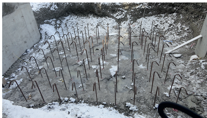
Устройство арматурных выпусков при увеличении толщины фундаментной плиты: арматура d=36 мм, глубина заделки L=1000 мм (завод по производству цемента, г. Новороссийск, 2012 г.)
