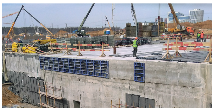
Организация арматурных выпусков при строительстве многоуровневой развязки и тоннеля под Калужским шоссе в районе ТПУ «Столбово» (Москва, 2018 г.)
